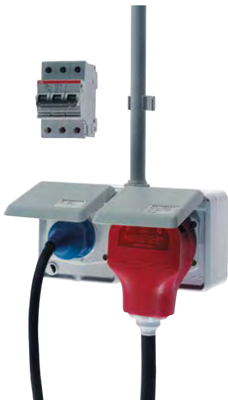
Eine häufig gewählte Steckdosenkombination: 16 A CEE und SCHUKO® 16 A. Bei Anschluss dieser Kombination über eine Zuleitung ist ein 3-poliger Automat obligatorisch.
