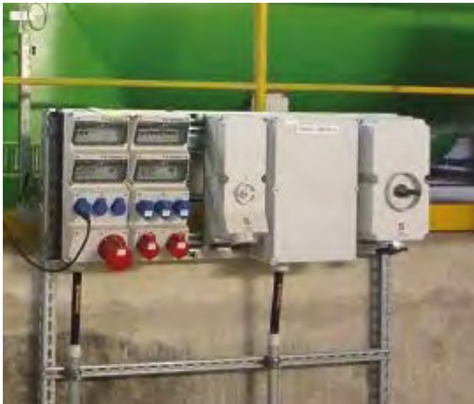
Salzgitter AG, Kraftwerk 4, Salzgitter, Deutschland
